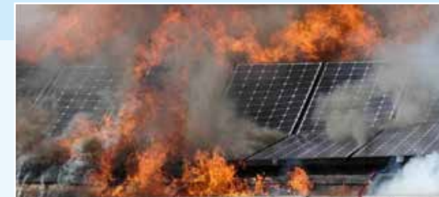
Požár fotovoltaických panelů na střeše rodinného domu
