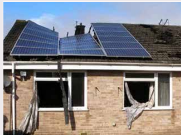
Požár fotovoltaických panelů – technická závada na propojení
