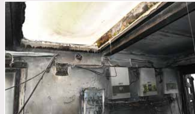
Požár střídačů a rozvaděčů v rodinném domě
