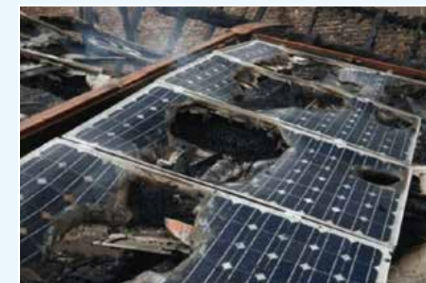
Požár fotovoltaických panelů – technická závada na panelech
