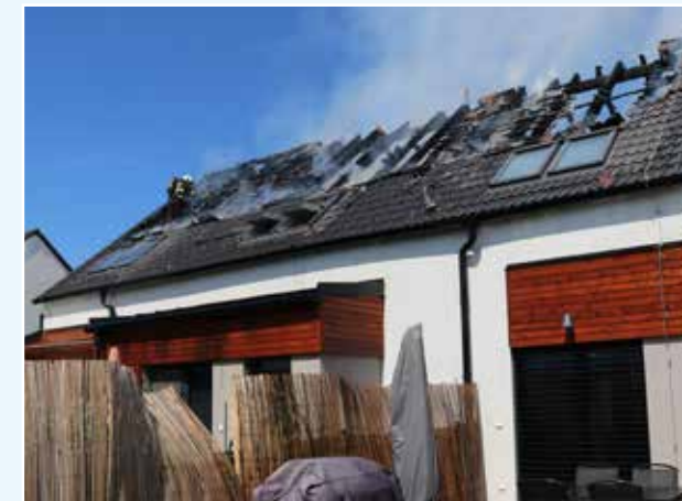
Požár fotovoltaických panelů na střeše řadového domu, instalace panelů nahrazuje střešní krytinu
